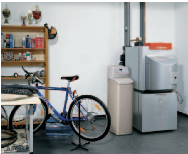
Stacja uzdatniania wody współpracująca z olejowym kotłem grzewczym.
