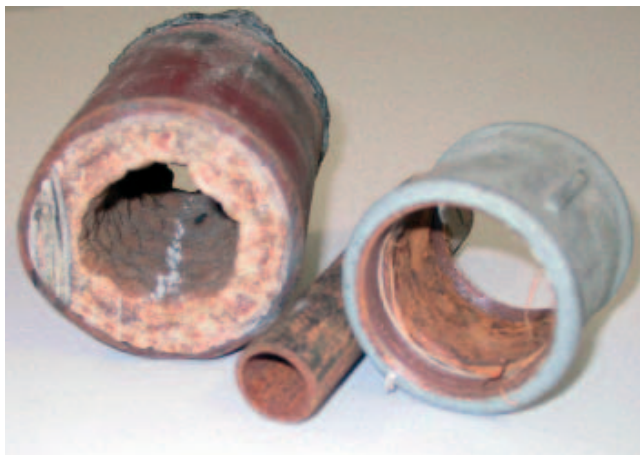
Instalacje grzewcze, wodne i kanalizacyjne pod wpływem twardej wody ulegają zniszczeniu.
