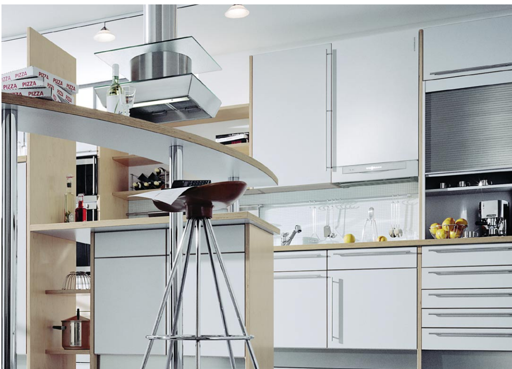
Gazowy, kondensacyjny kocioł wiszący Vitodens 300 w zabudowie kuchennej. Stylistyka urządzeń firmy Viessmann pozwala na umieszczanie kotłów wiszących niemalże w każdym pomieszczeniu.
