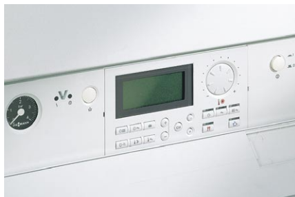
Регулятор Vitotronic 200 у корпусі настінного котла
