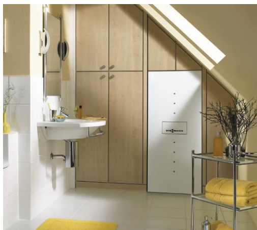
Przykład zabudowy kotła kondensacyjnego ze zintegrowanym zasobnikiem c.w.u. w łazience.
