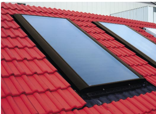
Vitosol 100 – płaski kolektor słoneczny wbudowany w połac dachu w nowo budowanym domu
