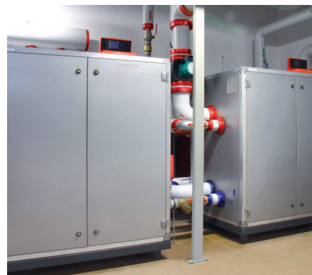
Kaskada dwóch pomp ciepła solanka/woda Vitocal 300-G Pro pracujące o łącznej mocy grzewczej 186 kW, – Hotel Arkas, Prószków
