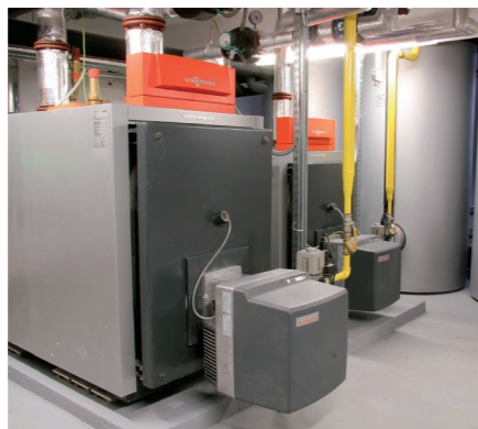
Dwa gazowe kotły Vitoplex 100, pracujące w kaskadzie o łącznej mocy 800 kW – Qubus Hotel w Gdańsku
