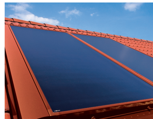
Kolektory słoneczne o wysokiej wydajności to idealne rozwiązanie do podgrzewania ciepłej wody użytkowej i wspomagania ogrzewania budynku.
