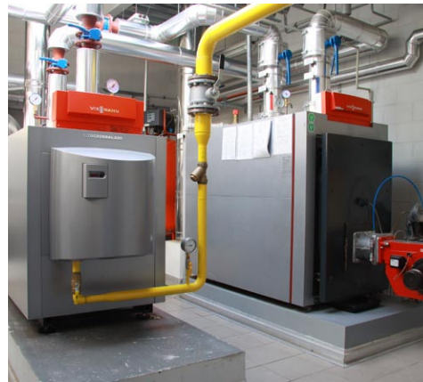
Dwa gazowe kotły: Vitocrossal 200 i Vitoplex 100, pracujące przy hali produkcyjnej w Poznaniu
