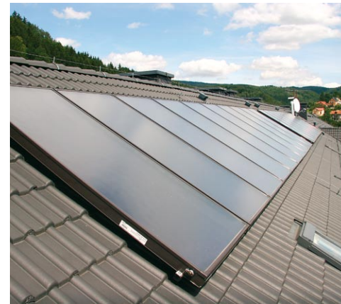
Bateria 20 kolektorów słonecznych Vitosol 200-F o łącznej powierzchni 46 m 2 na budynku usługowym
