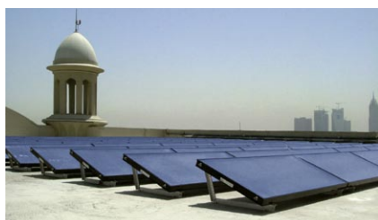
Kolektory słoneczne Vitosol 200-F zostały zainstalowane na dachach wieżowców.
