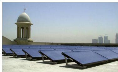
Kolektory słoneczne Vitosol 200-F zostały zainstalowane na dachach wieżowców.
