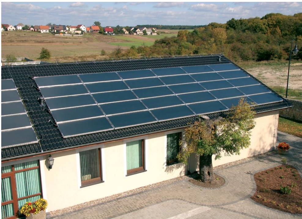
Instalacja grzewcza w „Sebastianeum Silesiacum” wspomagana jest przez płaskie kolektory słoneczne Vitosol 100-F, których łączna powierzchnia wynosi 140m 2 .
