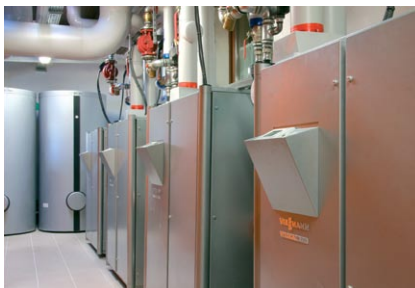
Obiekt ogrzewany jest za pomocą 5 pomp ciepła Vitocal 300 BW 280 o łącznej mocy grzewczej 408 kW.
