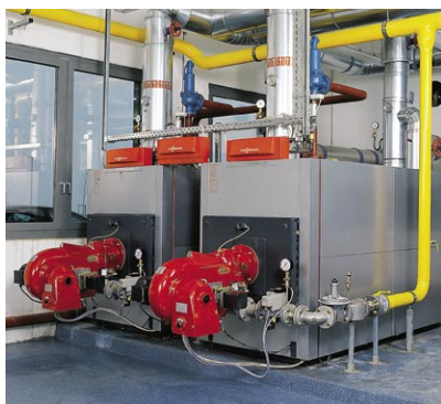
Kotłownia średniej mocy oparta o kotły kondensacyjne Vitocrossal
